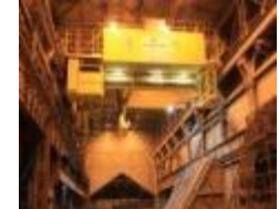
150 Metric Ton Tapping Crane (Swiss Steel)
